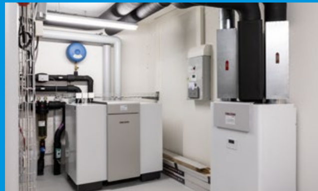
Jedes Haus ist mit einer WPF 20, einem Hygienespeicher SBS 1501 und einem Pufferspeicher SBP 700 ausgestattet.
