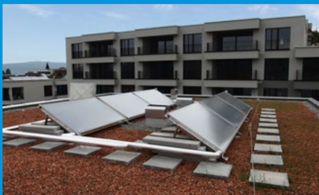
Solarkollektoren in der Siedlung Heidenkeller
